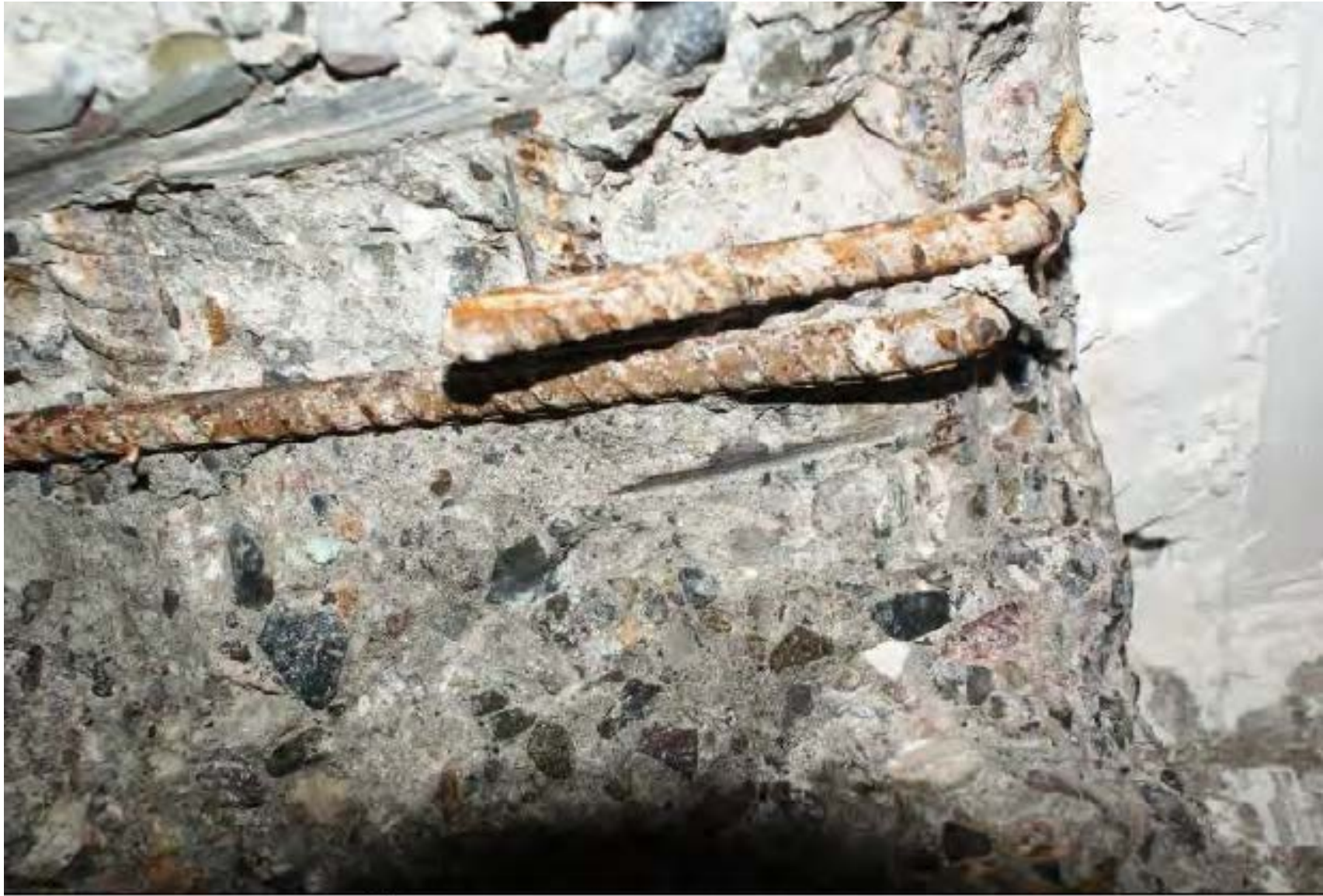
عدم رعایت خم ۱۳۵ درجه خاموت تیر در سونداژ محور A5 همکف
