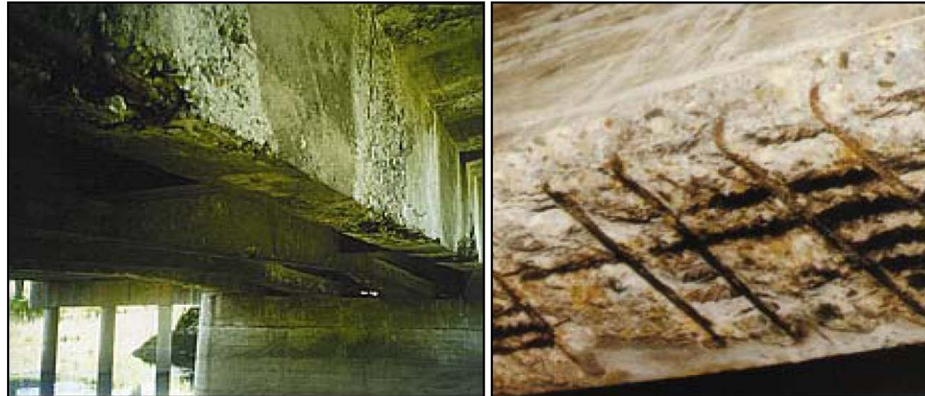
خرابی تیرها در اثر تهاجم یون های شیمیایی و تأثیر نیروهای لرزه ای
