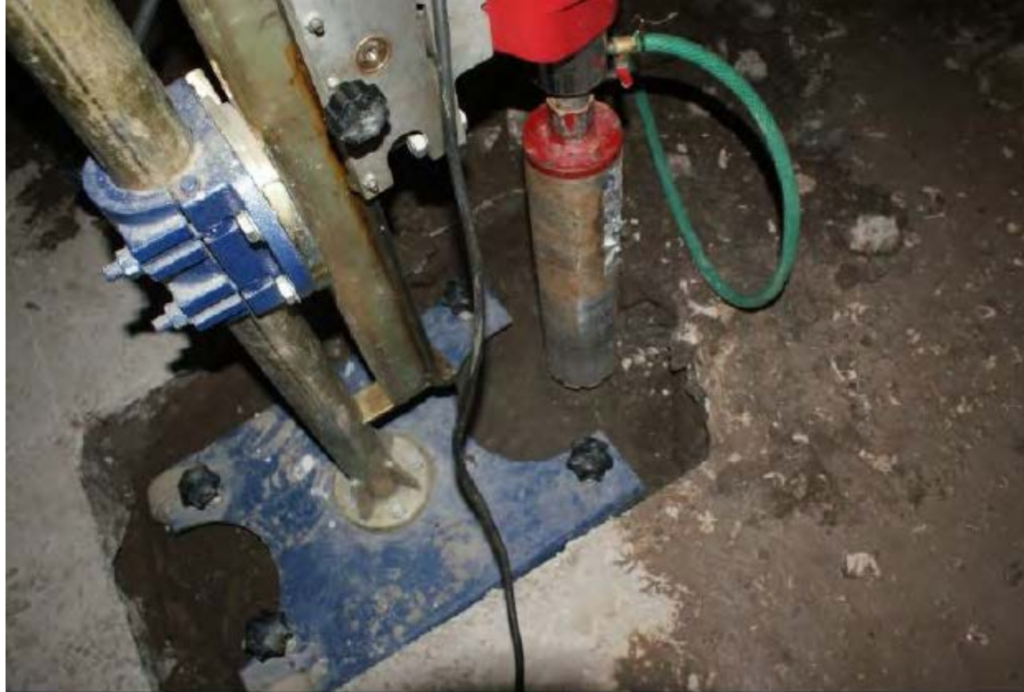
نمای نزدیک از مغزه گیری بتن از تیر اصلی طبقه اول (داخل مغازه)
